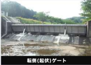
転倒(起伏)ゲート
